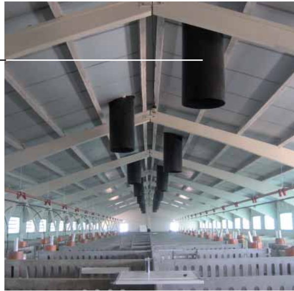
Sistema de Ventilación con Chimeneas
