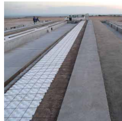
4 | Sistema de Calefacción.
